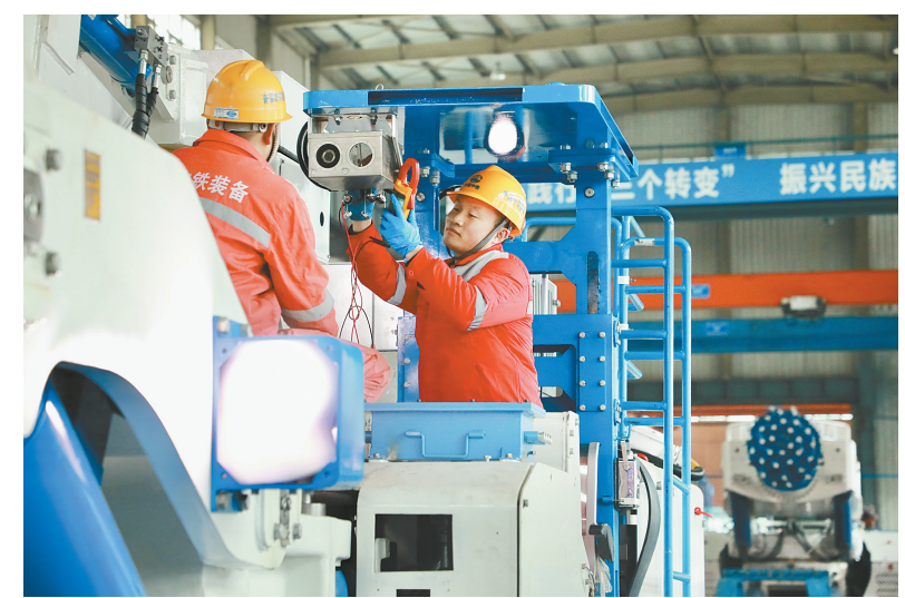
新年伊始,位于卫滨区的中铁工程装备集团隧道设备制造有限公司生产车间一派繁忙,工人们开足马力安装调试机器组件,加紧赶制订单,力争实现新年“开门红”。图为工作人员正在调试悬臂掘进机热成像仪。
