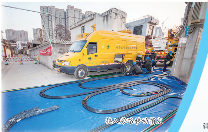
现场冒雨加固铁塔基础,保证国电线路在汛期安全稳定运行
