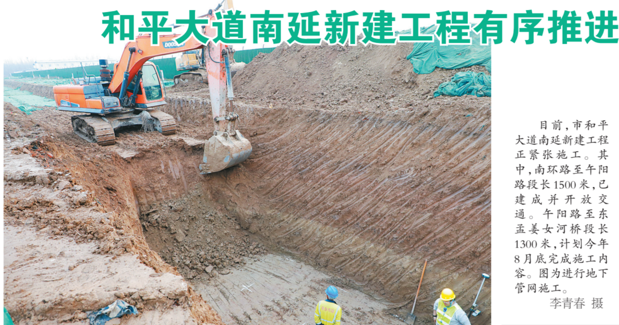
目前,市和平大道南延新建工程正紧张施工。其中,南环路至午阳路段长1500米,已建成并开放交通。午阳路至东孟姜女河桥段长1300米,计划今年8月底完成施工内容。图为进行地下管网施工。李青春 摄
