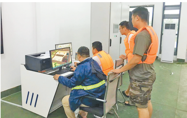
工作人员通过电脑实时观察泵站运行情况 陈卓 摄
