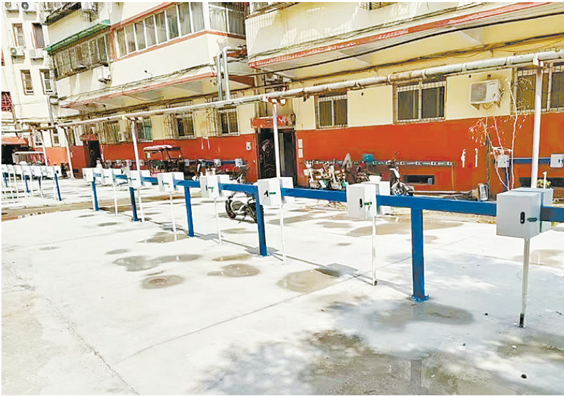
小区内安装好的充电桩
