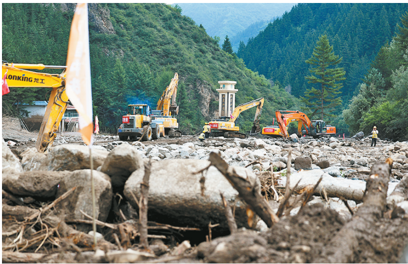
8月9日,在甘肃省兰州市榆中县兴隆山国家级自然保护区,抢险人员抢修受损的道路。 新华社发(侯崇慧 摄)
